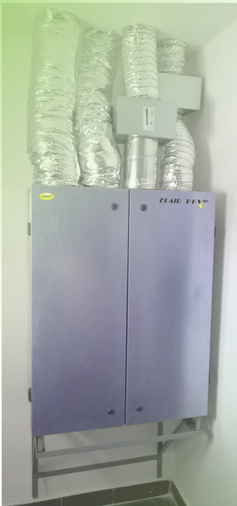
Příklad instalace jednotky P1-VHby (pasivní rekuperace s bypassem) v provozu zpracovatele masa.
